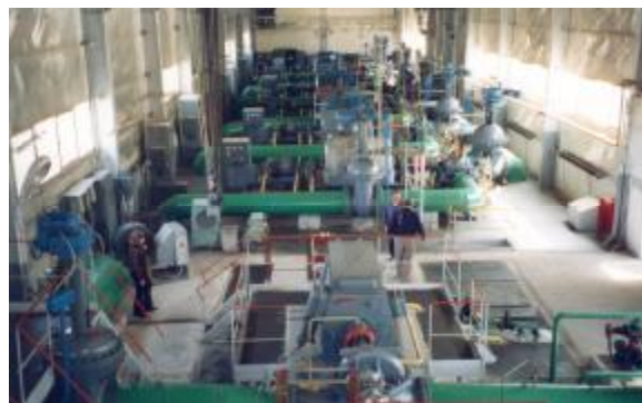
Магистральная насосная станция № 1
