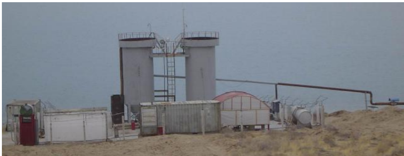
Локально-сорбционная установка на хвостохранилище ГМЗ-2
