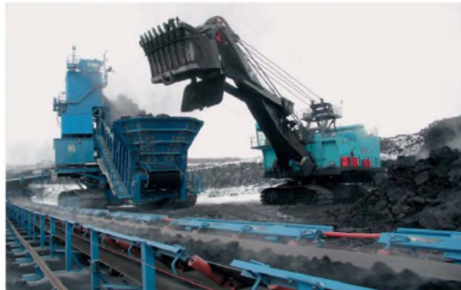
Рис. 6. Мобильная дробильная система в угольном разрезе «YiminHe» (работа продолжается при температуре до -48 °С)
